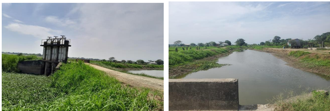
Ilustración 14. Compuertas y Canales de los Sistemas de Riego
